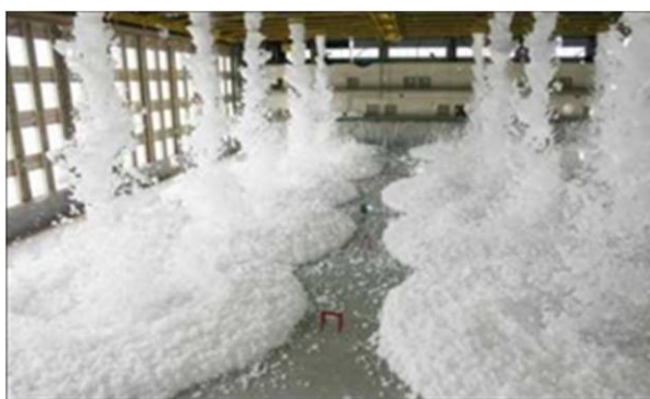
Рисунок 4 - Спринклерная установка пожаротушения.
